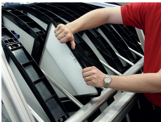
Figura 7.12 Estrazione dei pannelli del filtro.
